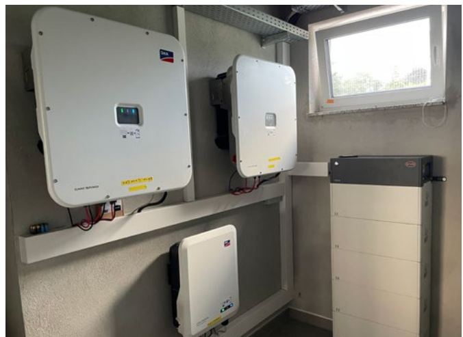
Die Wechselgleichrichter und Batteriespeicher der PV-Anlage im Erdgeschoss
