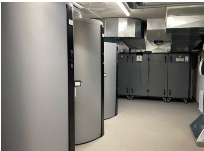
Technikraum im Obergeschoss mit den Pufferspeichern, der Lüftungsanlage und diversen Pumpen
